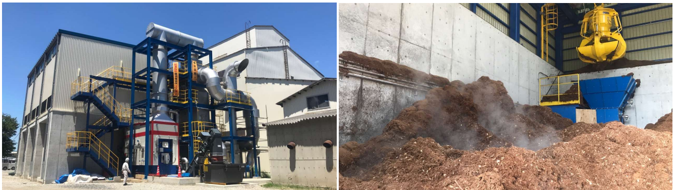
図1 バイオマス熱風炉の外観(左)、バイオマス燃料槽(右)
